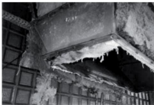
RYSUNEK 3. Płótno azbestowe w przewodach wentylacyjnych (PIP 2006, www.pip.pl ) FIGURE 3. The asbestos canvas in the ventilation ducts (PIP 2006, www.pip.pl )
